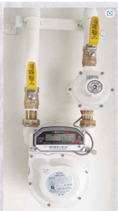
휴먼지엠테크와 휴콘스테크놀러지가 공동으로 특허등록한 승압방지장치기 설치된 모습.
